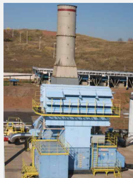
Рис. 1. Внешний облик газоперекачивающего агрегата
