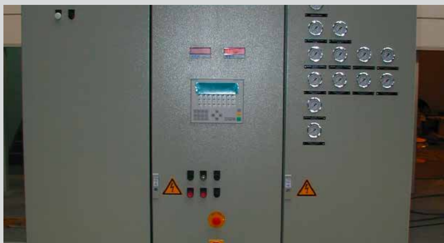
Фото 9. Шкафы для управления турбоколоколом
